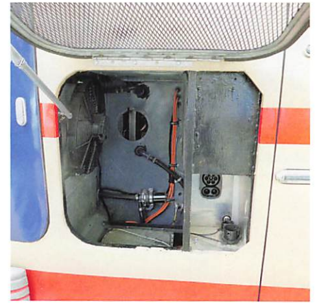
Hinten rechts befindet sich der Ladestecker, über den die Batterien mit maximal 11 kW geladen werden. Links unten im Fach ist das Ladegerät untergebracht.
