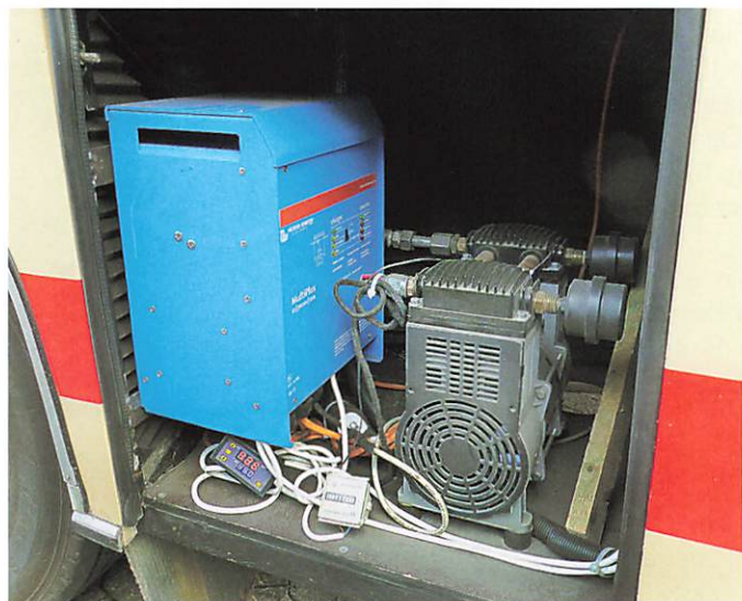
Ebenfalls auf der linken Fahrzeugseite untergebracht sind der Wechselrichter und der Luftkompressor.
